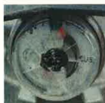
× 指示圧力計の損傷
