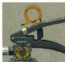
× 安全栓の抜けかけ
