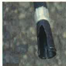
× ノズルの破損
