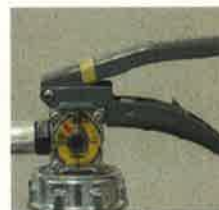
× 安全栓の脱落
