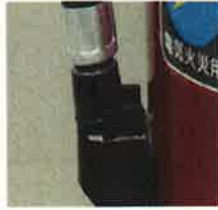
× 消火薬剤の漏れ
